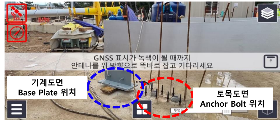
[ 시공 불일치 발견 ]
